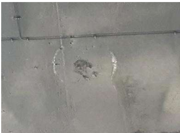
천장부 파손(A=0.2m×0.2m) SP-12
