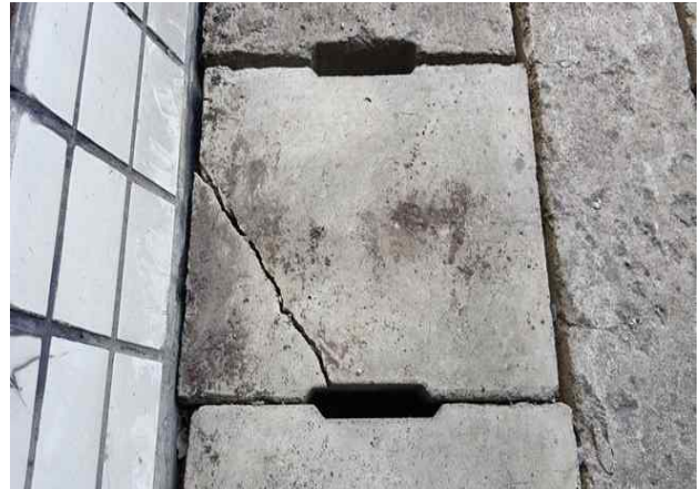
공동구 덮개 파손(1EA) SP-4
