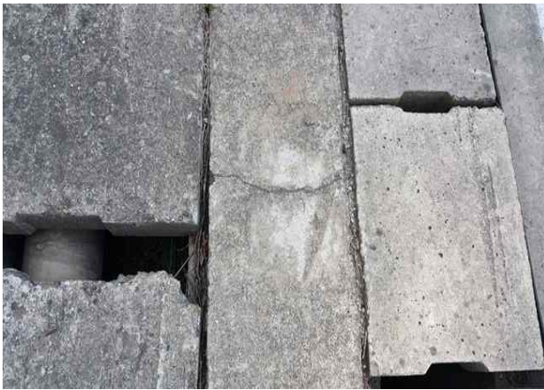
공동구 균열(Cw=0.2mm, L=0.3m) SP-2
