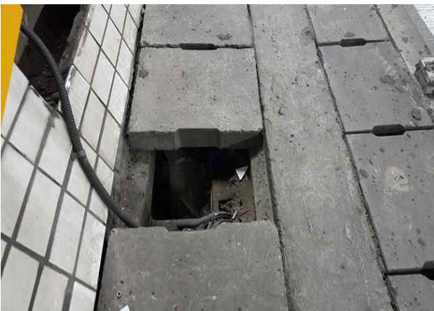
공동구 덮개 탈락(1EA) SP-35
