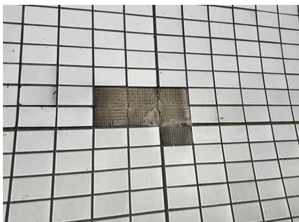
좌측벽 타일탈락 및 파손(7EA) SP-10
