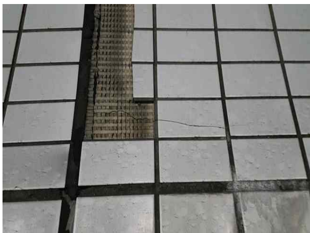
좌측벽 타일균열(L=0.6m) SP-9
